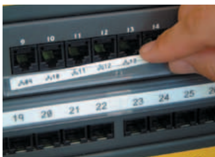
Маркировка монтажных блоков & патч-панелей
